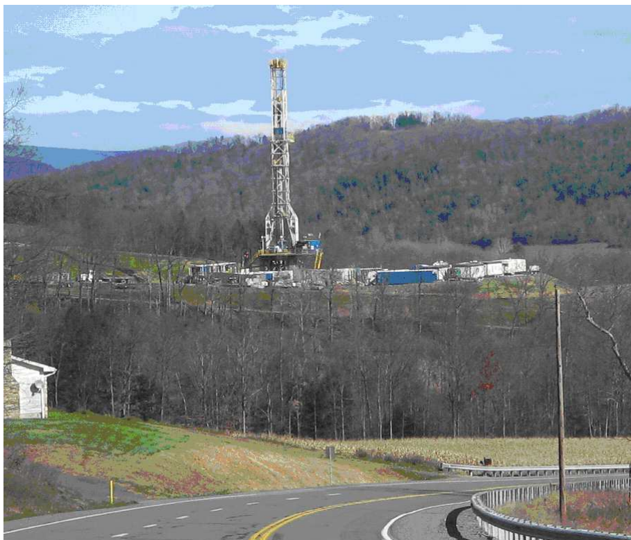
Photo : Puits d'extraction de gaz de schiste
